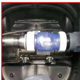
Zpětný ventil a čerpadlo odpadní vody
